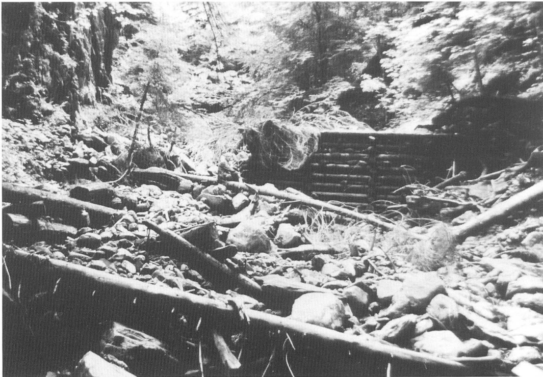
Abb. 1 Mangelnder Gewässerunterhalt; zerstörte Verbauungen erhöhen das Gefahrenpotential. Aufnahme: H.P. Willi, Bundesamt für Wasserwirtschaft, Bern
