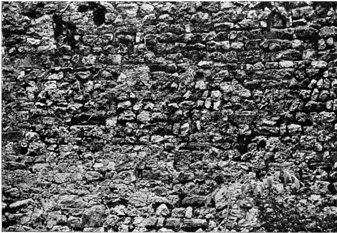
Abb. 18 Burgruine Badenweiler. Äussere Verblendung der NW Palasmauer. Struktur des Mauerwerks. Viele Handquader römischer Dimension von Hauptrogenstein. Tuffquader.
