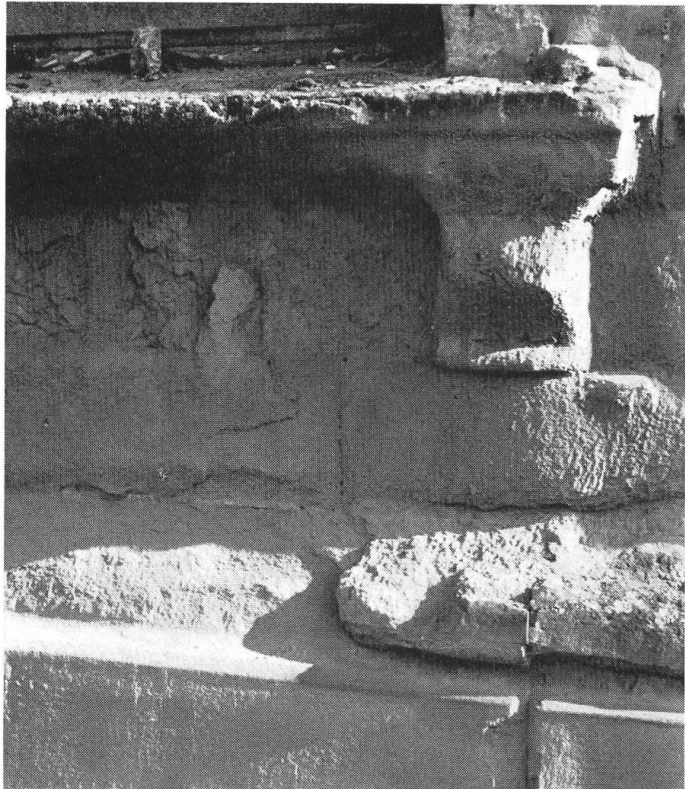
Abb. 15 Lörrach. Villa KBC, Baslerstr. 135. Baujahr 1864. Korrosion am Werkstein: Molassesandstein (Berner Sand- stein). Stark korrodierte Fenster- bank in Westexposition. Quader im aufgehenden Mauerwerk gehen bereits zu Bruch.
