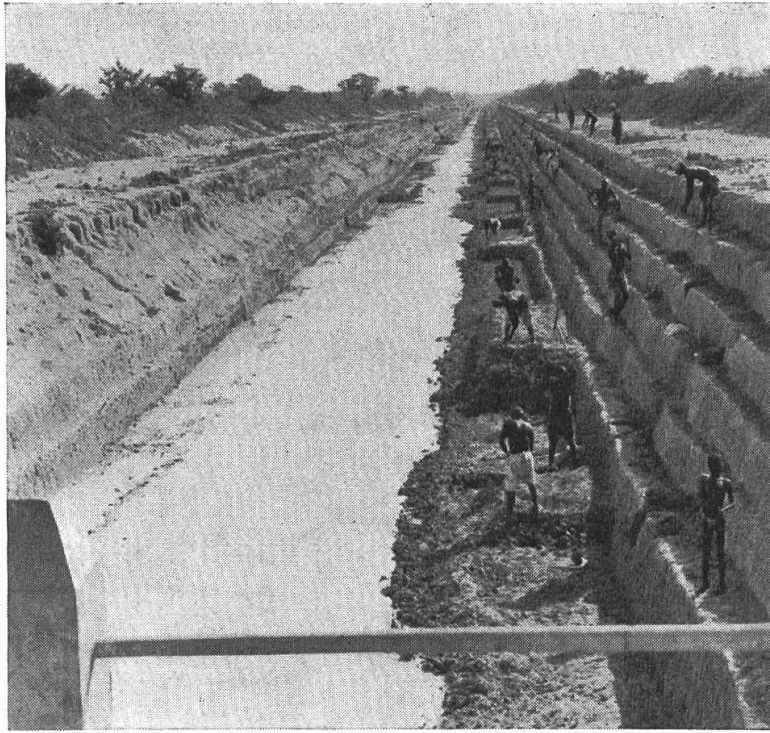
Abb. 4. Bau des Zuleitungskanals zum Meliorationsgebiet von Tamani-Konodimini bei Ségou. Durch seine Arbeit erhält der Afrikaner Anspruch auf eine Parzelle des meliorierten Landes. Photo Service de l'information du Soudan.
