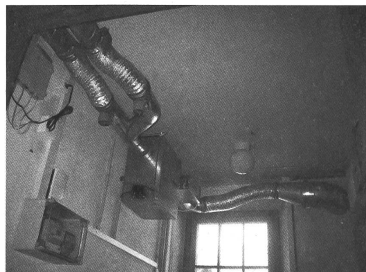
Figur 13 Ventilator und Steuerung in Nebenraum des Kindergartens
