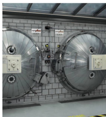
L'installation papersave swiss à Wimmis. Les deux chambres sont fermées: l'installation est en service.
