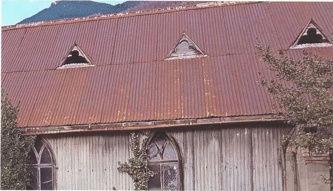
[E] Il tetto (lato nord) con le sue aperture di ventilazione. Fotografia dell'autrice
