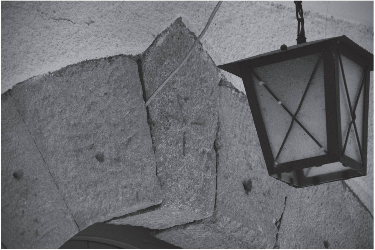
Figura 2a: Dettaglio della chiave di volta con la croce di Malta bene in vista.
