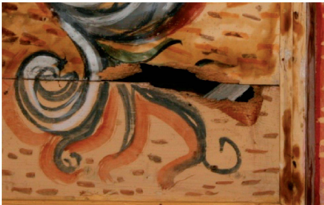
L'assito è talvolta debole e lacunoso. Attraverso larghe fessure l'ambiente della chiesa comunica direttamente con il sottotetto
