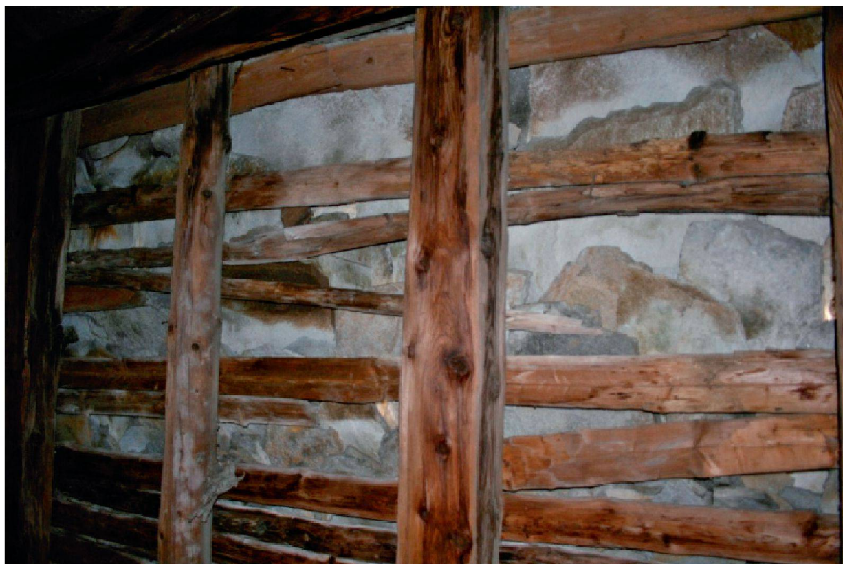
Nelle coperture mancano in diversi punti i sostegni delle piode causando un avvallamento del manto
