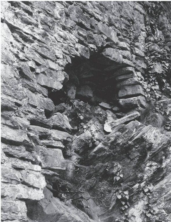
Ill. 2 - Castello di Mesocco. Guasti nella muratura e nel basamento roccioso della torre nord (3)
