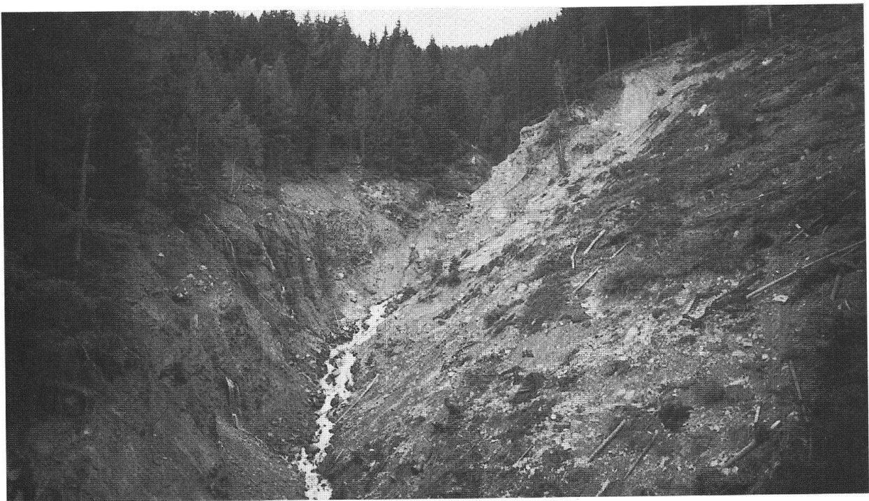
Il medesimo tratto fluviale dilavato con i fianchi resi instabili dalle due catastrofi del 1987. La profondità erosiva in questo punto raggiunge gli 8 metri circa, e la capacità erosiva 300 \text{ m}^3/\text{m} .
