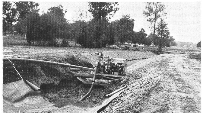
Abb. 12. Anfang der Abdichtungsstrecke mit dem KDB mit Pumpe für das Absaugen des von Oberstrom unter der KDB fliessenden Wassers. Im Hintergrund der fertige Kanal (ohne Dichtung). (Fotos Sarna Kunststoff AG, Sarnen)
