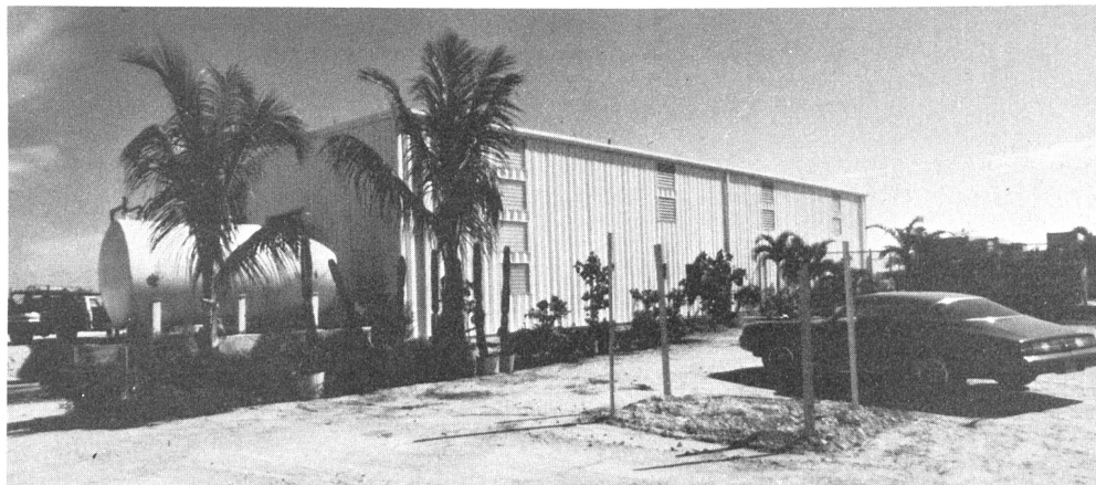
Die neue Umkehrosmoseanlage befindet sich auf Stock Island in der Nähe von Key West, Florida.
