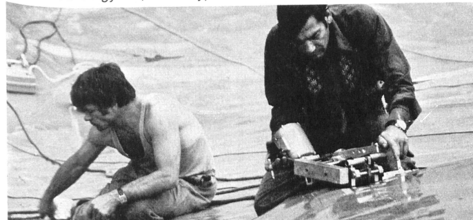
Verschweissen der ausgelegten KDB mit dem von der Sarna Kunststoff AG entwickelten automatisch arbeitenden Heizkeil-Schweissapparat, mit dem zwei nebeneinanderliegende Schweissnähte mit dazwischenliegenden Prüfkanal erzeugt werden. Anschliessend werden die Schweissnähte auf Dichtigkeit und mechanische Widerstandsfähigkeit geprüft. (Foto: Ciba-Geigy AG, Monthey).
