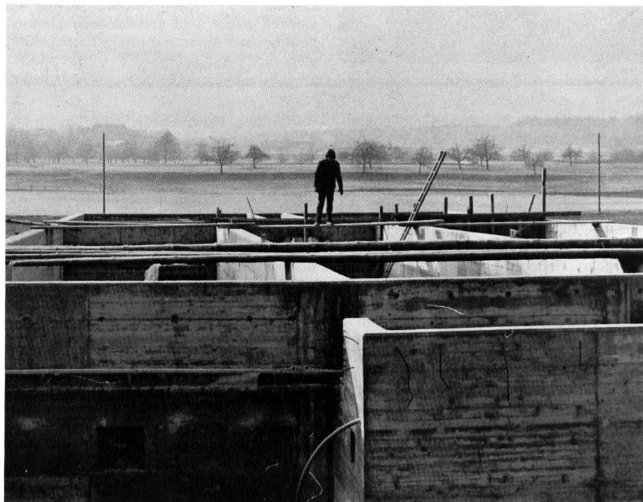
Abb. 1. Die regionale Abwasserreinigungsanlage in Ellikon an der Thur ist im Rohbau fertig erstellt. Unsere Aufnahme zeigt das Dienstgebäude und die Nachklärbecken
