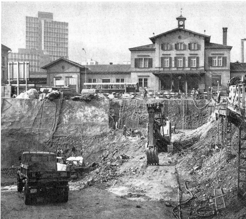
Abb. 10. Baden; Neugestaltung des Bahnhofquartiers in Ausführung. Baugrube für zwei unterirdische Parkierungsgeschosse, über denen eine verkehrsfreie Fussgängerebene und eine Verkehrsebene angelegt werden
