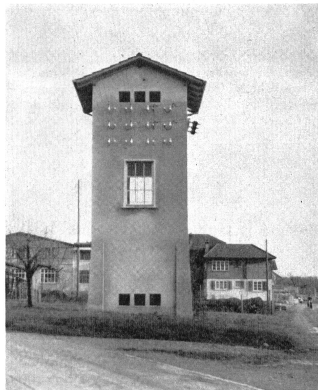
Abb. 2. Typische Hochstation, wie sie fast in jeder Gemeinde anzutreffen ist. Wer Näheres erfahren möchte über die Bemühungen der Elektrizitätswerke, für Transformatorenstationen baulich befriedigende Lösungen zu finden, wird auf den in der Zeitschrift «Heimatschutz» 1952, S. 119 ff., erschienenen Aufsatz aufmerksam gemacht.
