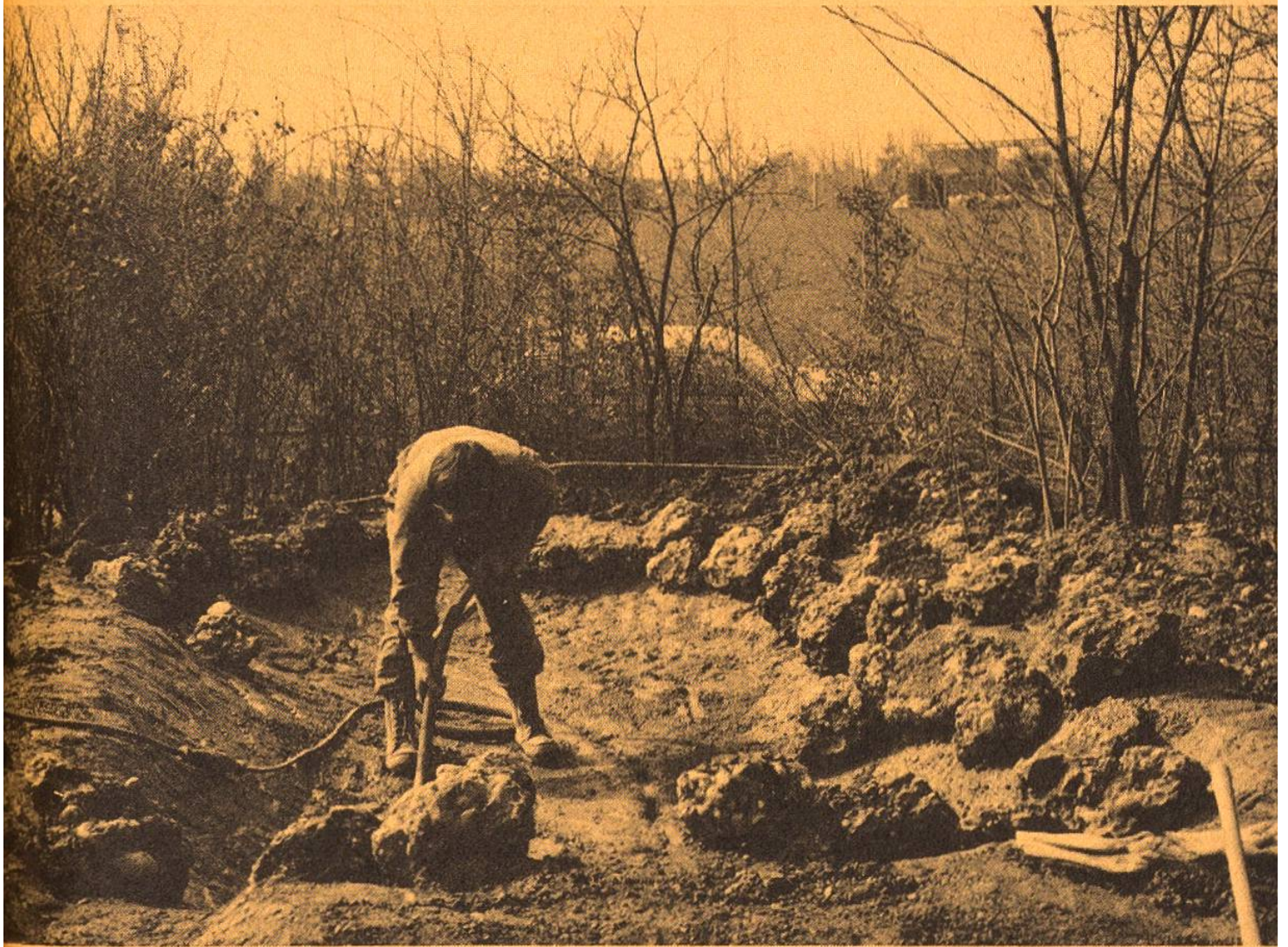
Der Bau eines Biotops ist harte Knochenarbeit. Hier entsteht ein Laichbecken für Unken.
