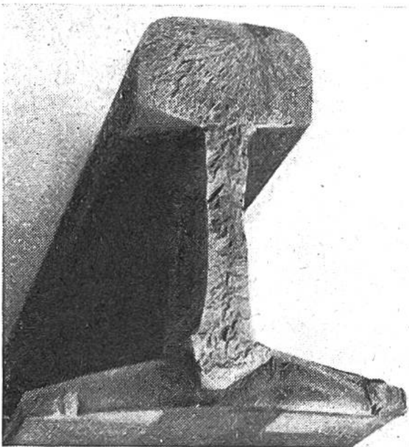
Abb. 8: Dauerbruch einer Schiene.
