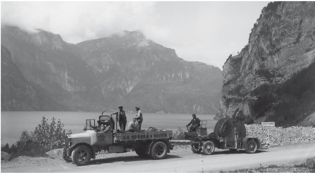
Schwachstromkabelverlegung durch Kummler & Matter für die Schweizerische Telefonverwaltung 1921/22 auf den Strecken Luzern–Axenstrasse–Altdorf und Chur–Landquart
