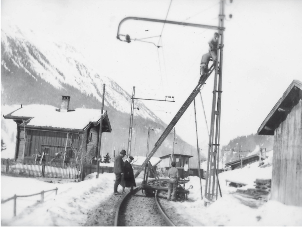
Bild links: Hermann Kummeler (im Mantel) inspiziert die Installationen im Winter 1918/19, Station Bergün, Ausfahrkurve Seite Muot
