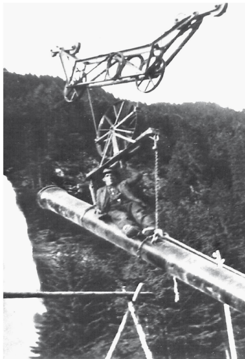
Kabelkran zum Bau des Kraftwerks Tagenstall, Engelberg. Auch da posiert Karl Garaventa mit Hut in luftiger Höhe. Ca. 1942 bis 1944.
