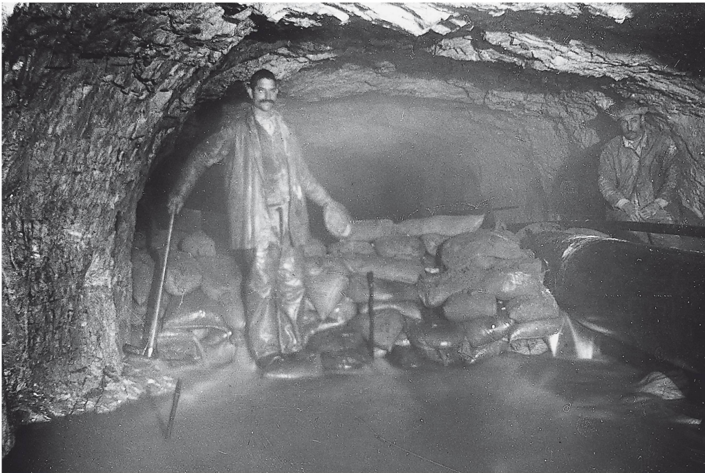
Der Kampf der Tunnelbauer ist hart. Im Grenchenberg wurde bei Km 1.615 eine Grotte angefahren, was die Trinkwasserversorgung der Stadt Grenchen versiegen liess.
