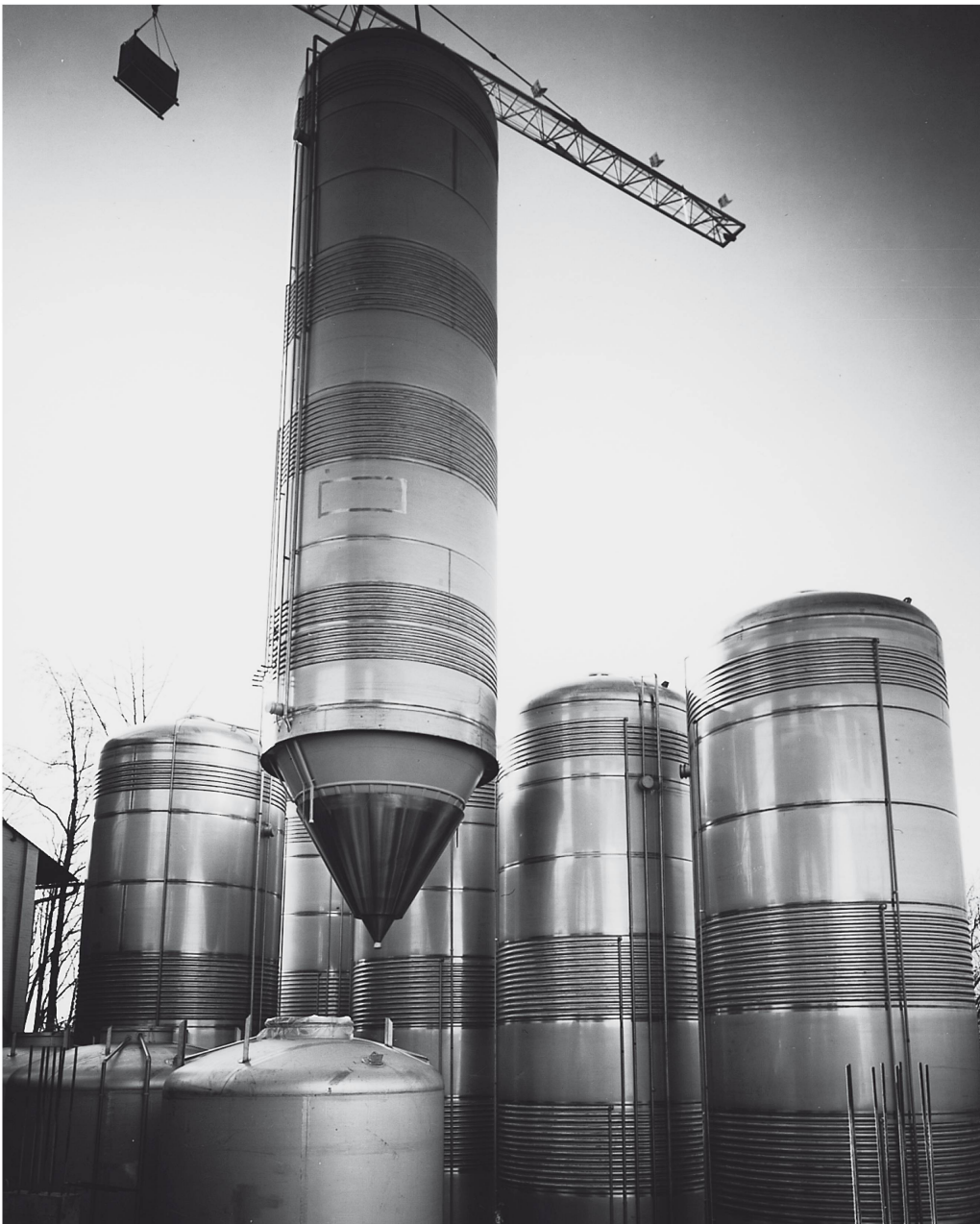
1986: Mit der neuen Gärtankanlage hatten die offenen Bottiche im Gärkeller ausgedient.
