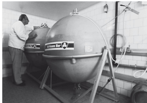
Bier-Drive-Tanks im Restaurantkeller
