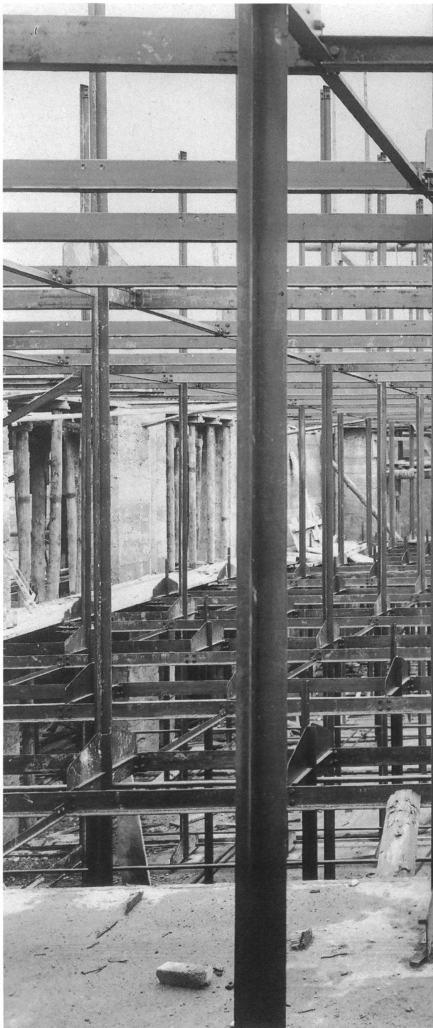
Skelettbau der Stadtbibliothek Winterthur um 1916. Die Ständer und Riegel der Bücherregale bilden zugleich die Tragkonstruktion.
