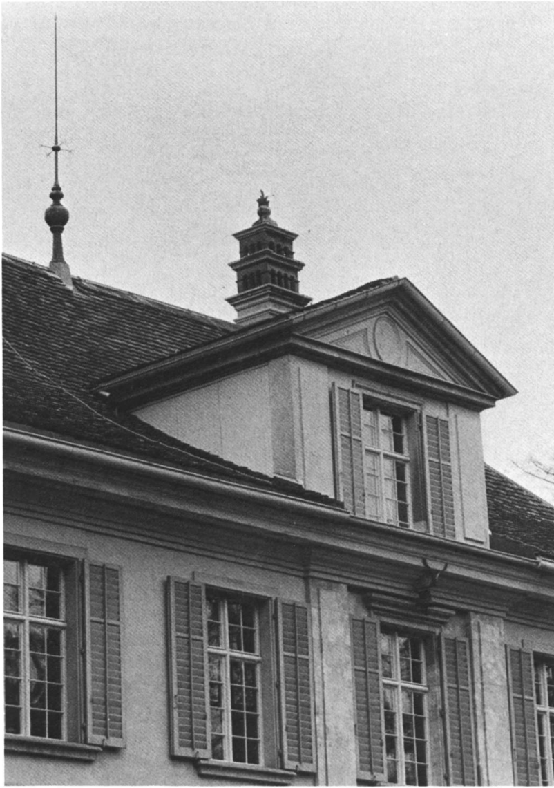
Blitzableiter auf dem Dach des Lindenguts, ältester erhaltener in Winterthur
