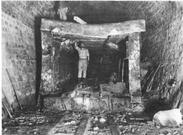
An den gefährlichsten Druckstellen wurden Einbauten aus Eisen angebracht, aber von der Gewalt der Gebirgsmassen trotzdem zusammengedrückt. Sie wurden erst nach der Ausmauerung des Tunnelgewölbes entfernt.
