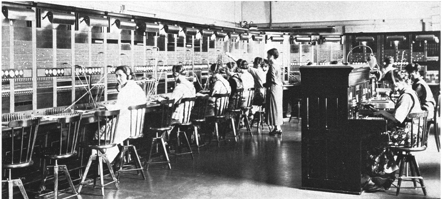
Blick in die Zentralbatterie-Universalzentrale, die in Aarau auf das eidgenössische Schützenfest 1924 hin in Betrieb gesetzt worden war.
