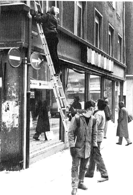
Leitungsbau für die Übung PEGASUS mitten in der Innenstadt von St. Gallen. Die Funkerkurschüler lernten so die Stadt auch von einer anderen Seite kennen. Foto: Ralph A. Ottinger
