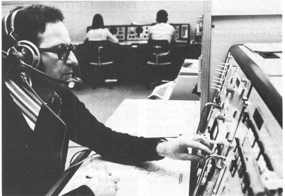
Das Bild zeigt einen Telefonie-Vermittlungsplatz der Küstenfunkstelle Bern Radio; Sender und Empfänger werden ferngesteuert. Im Hintergrund sind zwei Telegrafie-Arbeitsplätze sichtbar.
