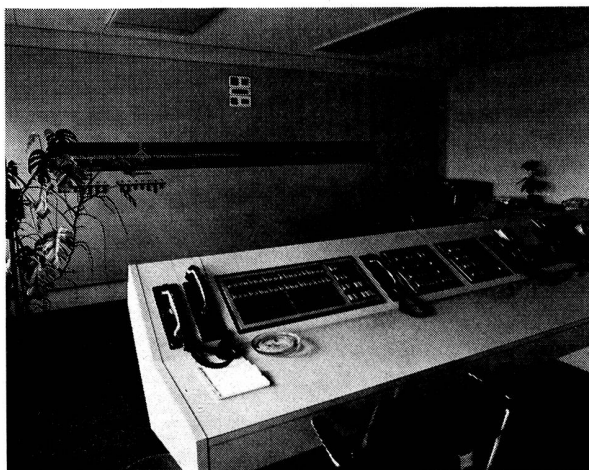
Fig. 2 Uebermittlungszentrum eines Polizeistützpunktes
