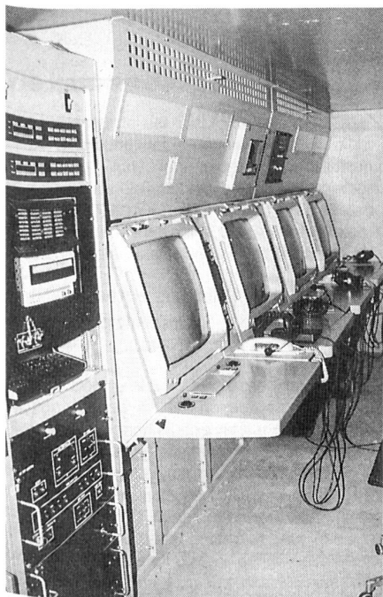
Blick in den Operations-Shelter mit den 4 Multi-Mode-Displays und Übermittlungskonsolen. Vue d'un shelter-opération entre les 4 multi-mode-displays et les pupitres de transmission.
