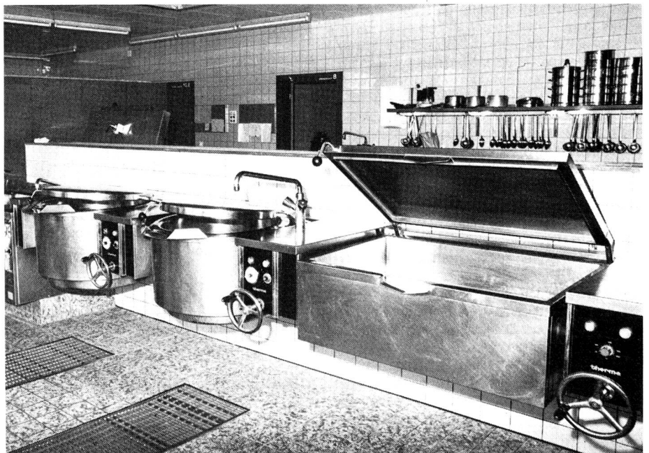
Grosszügig und modern eingerichtete Kompanieküche, Kaserne Kloten
