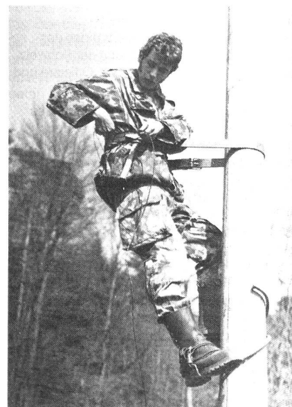
Die TT-Leitungen müssen oftmals im Truppenbau bis in die Übermittlungszentren verlängert werden.
