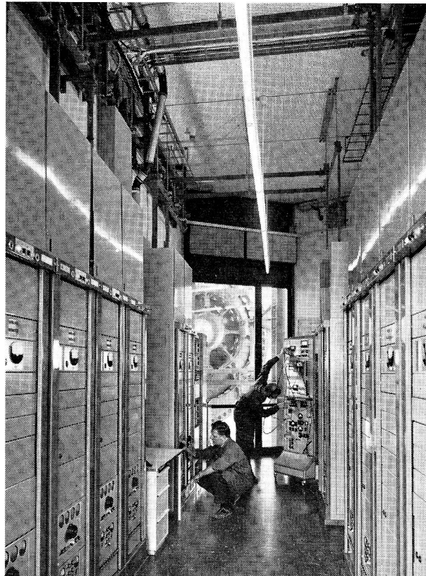
Fig. 4. Sende- und Empfangsausrüstungen für 4-GHz-Richtstrahl-Telephonie
