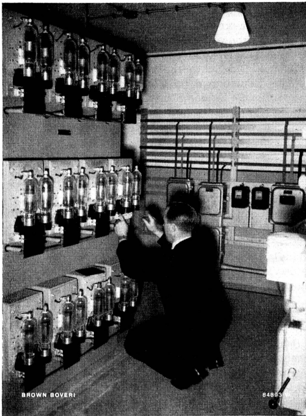
50-kW-Schneisenbeleuchtungsanlage im Flughafen Schiphol, Holland. Mit 12 Thyralux-Geräten, vier je Phase, wird die dreiphasige Anlage stufenlos und trägeitslos gesteuert.
