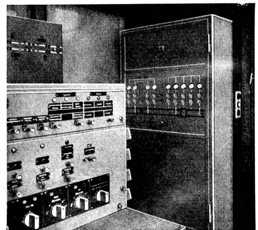
Fernsteuerungsanlage, Bahnhof Göschenen
