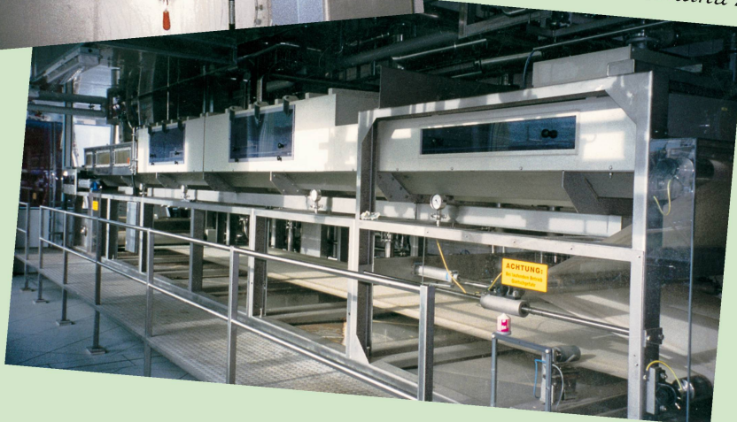
Installation d'extraction en continu 2
