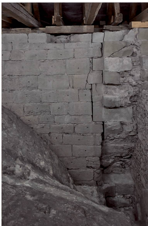
Abb. 57 Befund zwischen Gewölbe und Dachwerk, Baunaht zwischen Chor und Obergaden auf der Nordseite, in der Mitte Ausbruch der Westmauer des Chorturms, links anschliessend Obergaden, unten und rechts erneuerter Chorbogen und Mauer von 1630.
