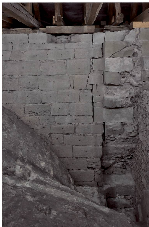
Abb. 57 Befund zwischen Gewölbe und Dachwerk, Baunaht zwischen Chor und Obergaden auf der Nordseite, in der Mitte Ausbruch der Westmauer des Chorturms, links anschliessend Obergaden, unten und rechts erneuertes Chorbogen und Mauer von 1630.
