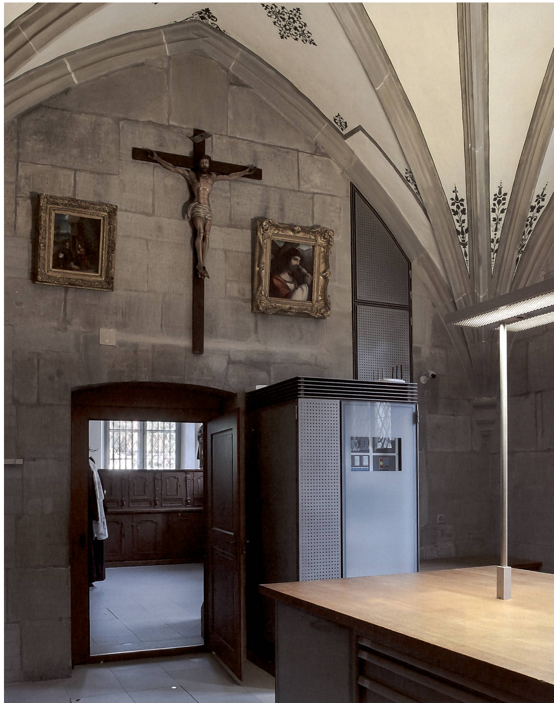
Fig. 15 Une touche contemporaine dans la grande sacristie de 1628: nouveau meuble des parements au premier plan, armoire des serveurs et tableaux de contrôle, devant l'ancien conduit de cheminée abritant désormais les câblages.
