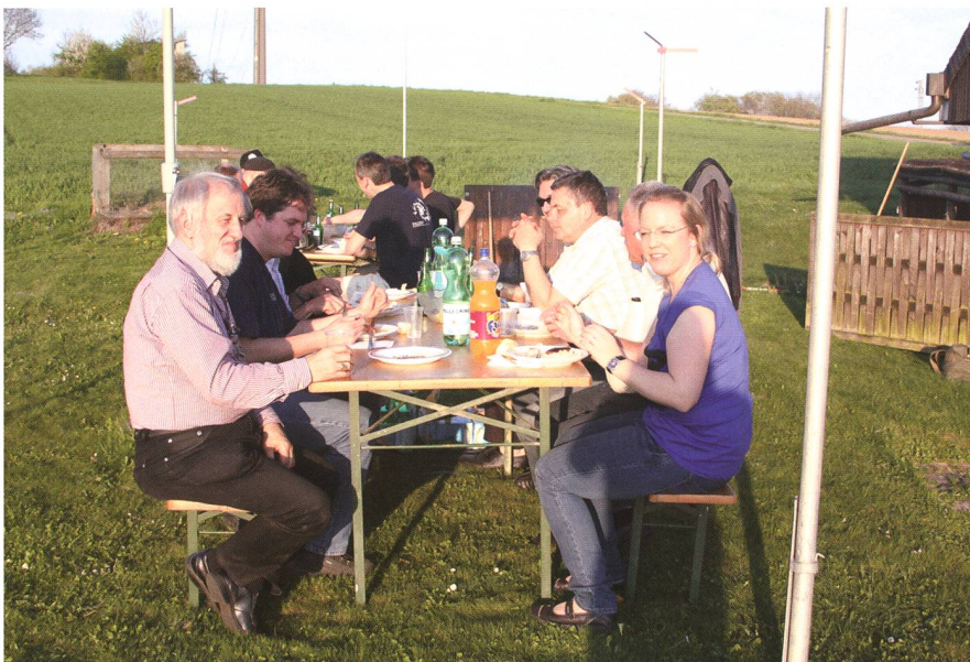
Zwischen den Baugespannen, wo der Anbau an die bestehende Bülacher Sternwarte entsteht, wird für einmal «Gastronomie» betrieben. (Foto: Thomas Baer)
