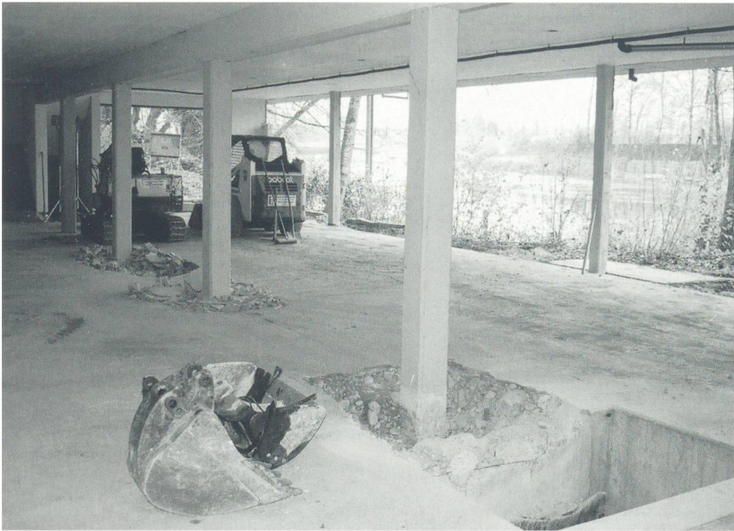
Blick in die ausgeräumte Bootshalle. Im Vordergrund gähnt der Schacht des Ruderrechens. Die Stirnwände sind bereits ausgebrochen. Eben ist die Längswand gegen die Aare gefallen. Die Betonpfähle werden stehen bleiben und Teil des «verlängerten» Fundaments werden.
