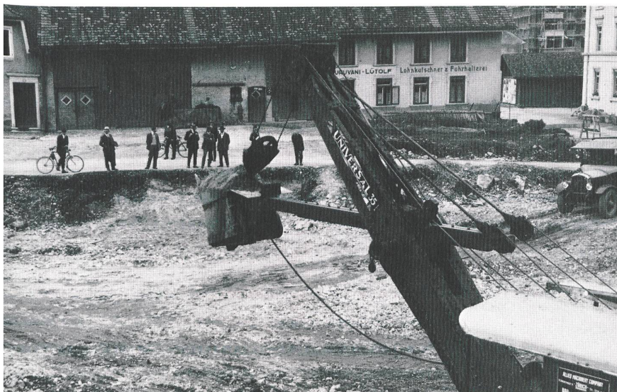
Blick in die Baugrube für das Feuerwehrgebäude 1930. Im Hintergrund die Bauten Nrn. 192–193.
