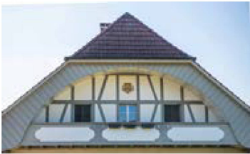
Das Jenzerwappen im Giebelfeld deutet auf den Erbauer und die Besitzerfamilie. Foto: Urs Ingold
