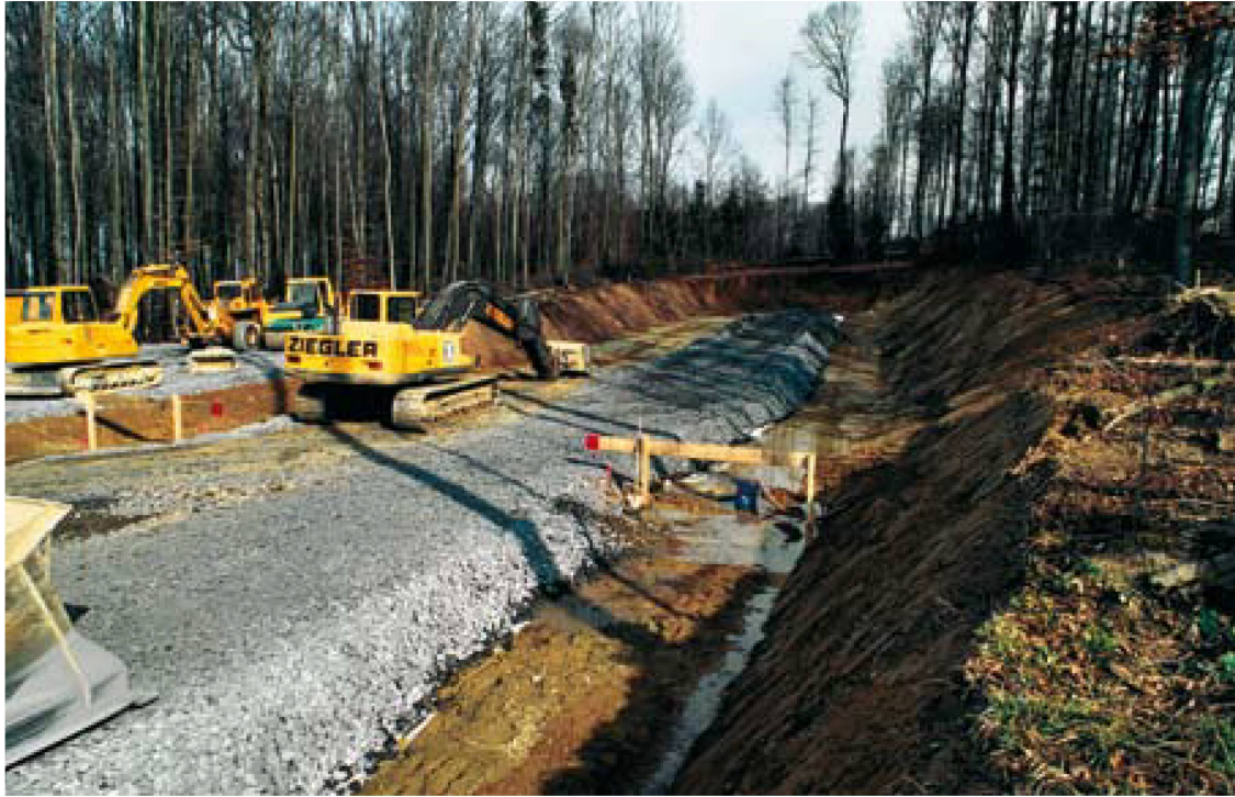
Eingebrochenes Tunnelstück am Önzberg. Fotos Verfasser
