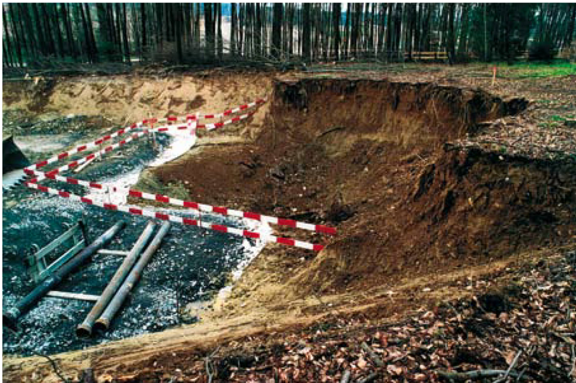
Abrisskante der Einsturzstelle
