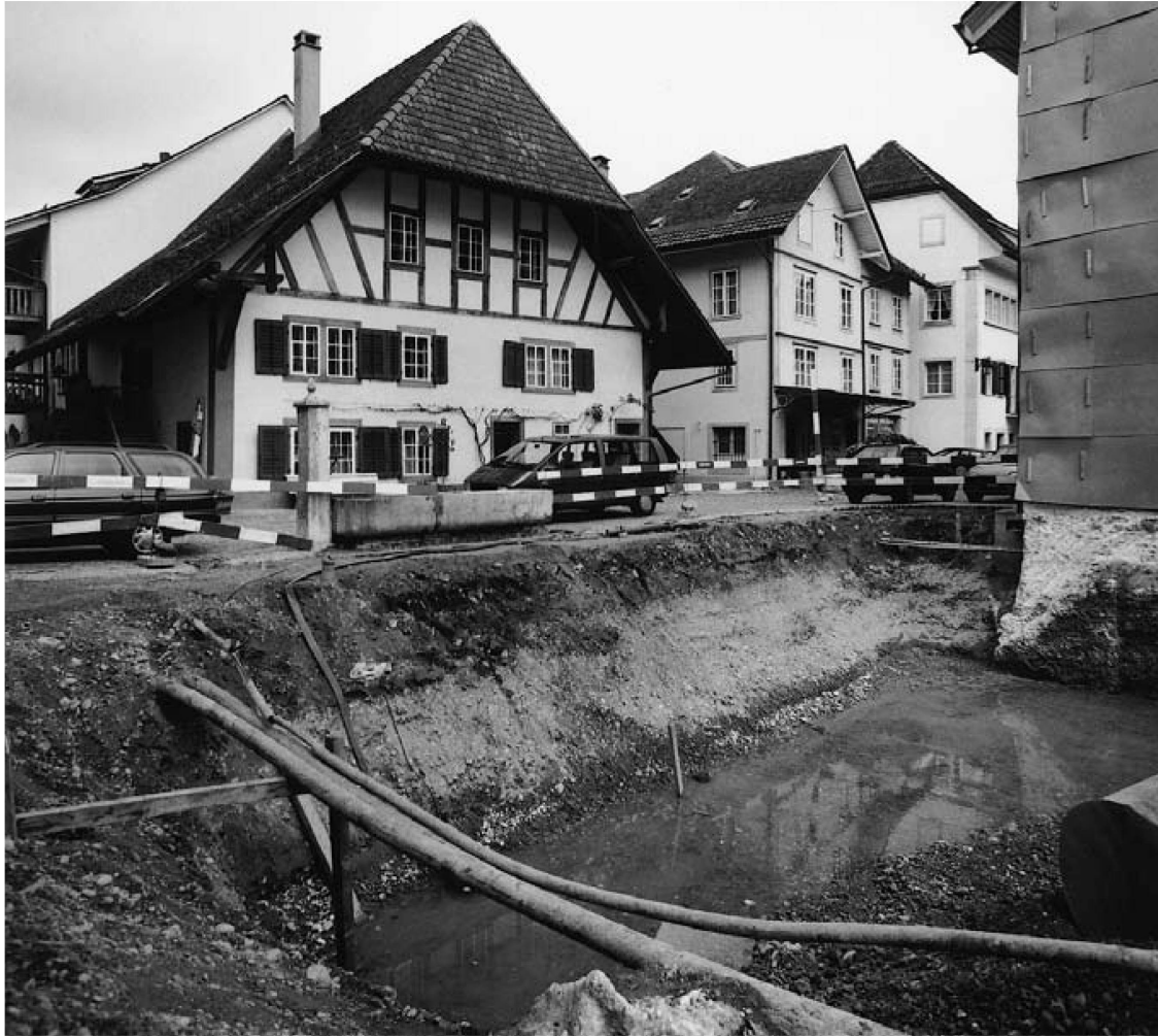
In der Baugrube zeigen sich mächtige Sedimente der Aare. Blick (April 1994) nach Nordosten in die offene Baugrube. Foto Archäologischer Dienst des Kt. Bern (ADB)
