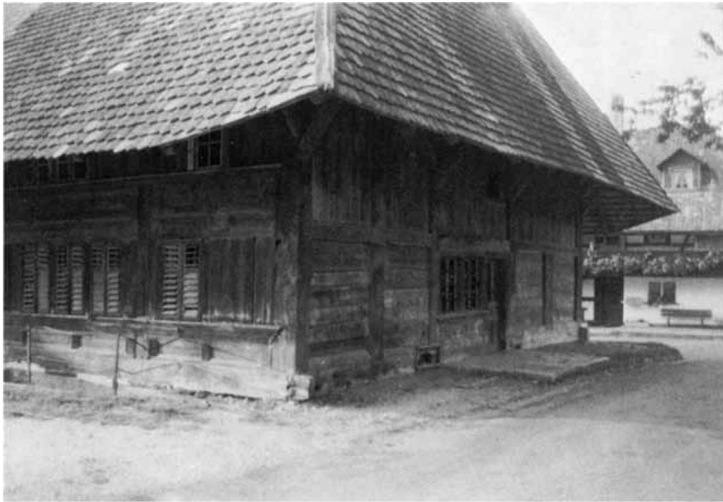
Abb. 16. Hochstudhaus Ecke Jägerweg–Länggasse Herzogenbuchsee. Nur die Küche hat Fenster; das Loch im Gadengeschoss ist nicht original, hingegen die hier nicht sichtbaren Rauchschnitte der Rauchkammer. Die laubenlose und fensterarme Giebelseite steht im Gegensatz zu den beiden Traufseiten. Eines der wenigen Häuser, mit denen sich das abgebrochene Gebäude in Niederönz vergleichen lässt, wenngleich das hier abgebildete Haus beträchtlich höher gebaut ist. Foto W. Gfeller
