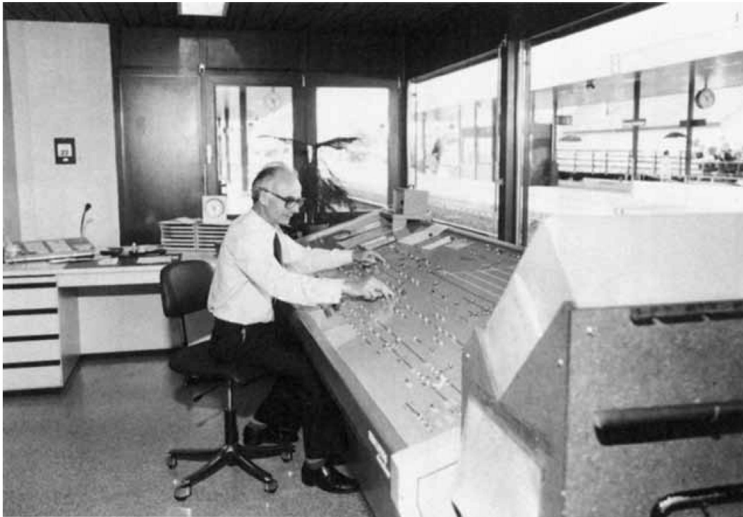
Domino-Stellwerk und elektrische Sicherungsanlagen. Gute Sicht auf die Geleiseanlagen.
