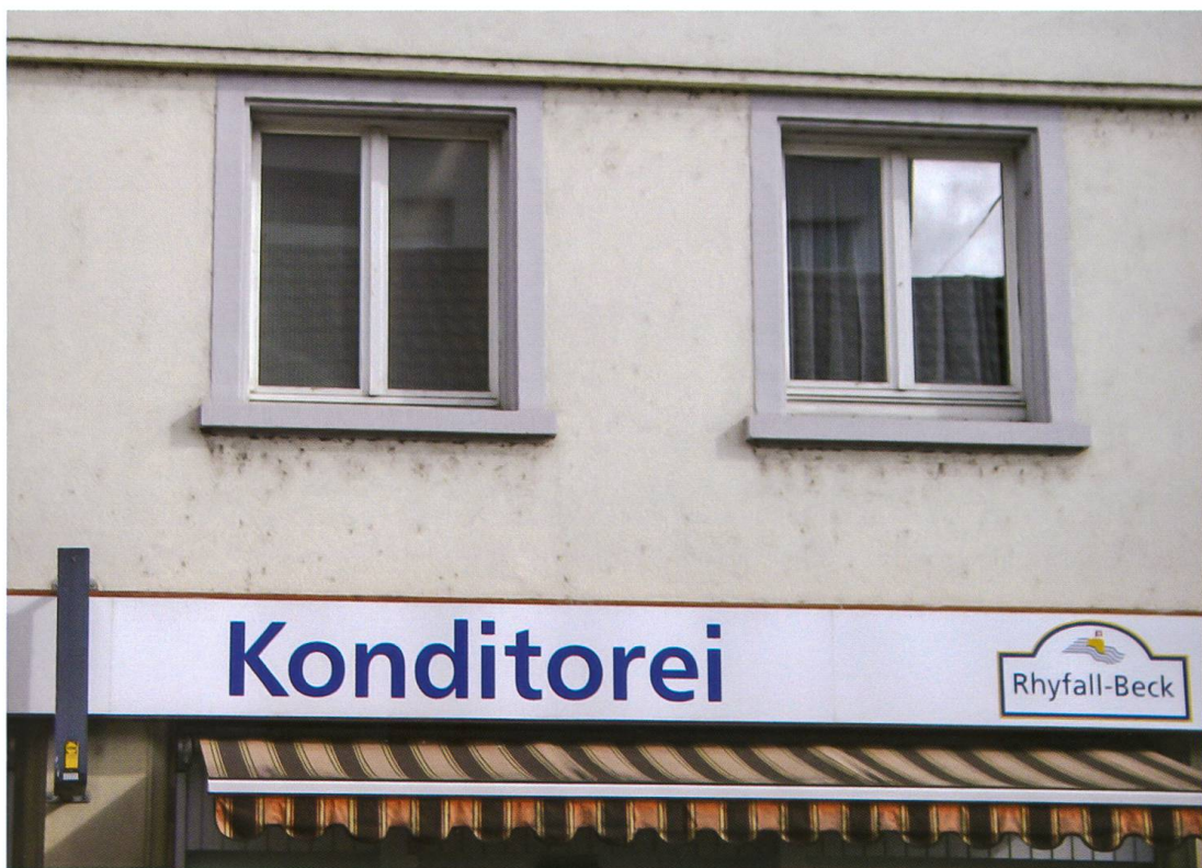
Neuhausen, Zentralstrasse 58. Die Netzchen der Mauerspinne, zusammen mit Russ und Staub aus der Umgebung, verleihen der Fassade eine Patina von Verwahrlosung.
