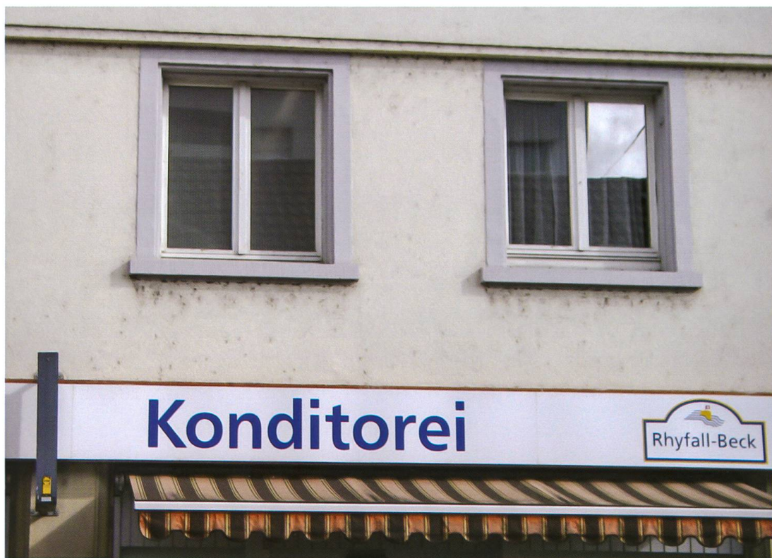
Neuhausen, Zentralstrasse 58. Die Netzchen der Mauerspinne, zusammen mit Russ und Staub aus der Umgebung, verleihen der Fassade eine Patina von Verwahrlosung.
