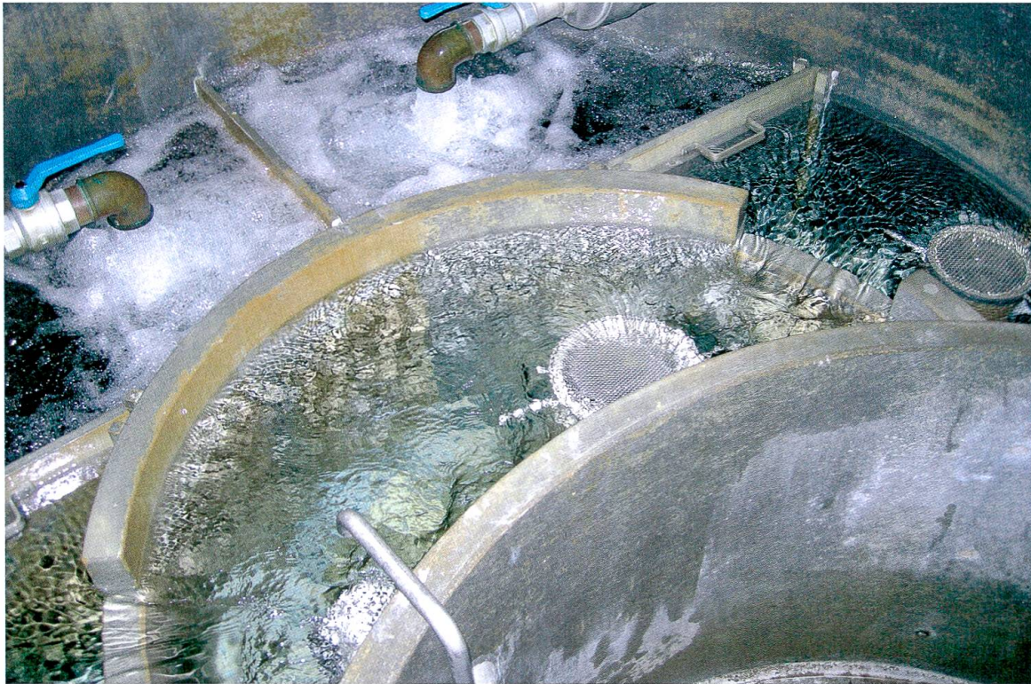
74 Brunnenstube mit Quelleinläufen, Beruhigungsbecken, Überlaufstutzen, Trinkwasserseihier und Trockeneinstieg (Vordergrund), Januar 2008. Foto: ALU
