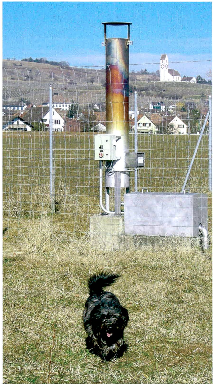
95 ARA Hallau, Gasfackel. Foto: ALU
