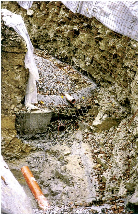
68 Drainageröhre (oben) und Trinkwasserfassungsstrang (unten), 1989. Foto: ALU
